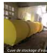
Cuve de stockage d'eau
